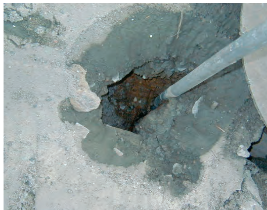
Bild 8: Bei der Perforation entstandene Wegsamkeit bis GOK
