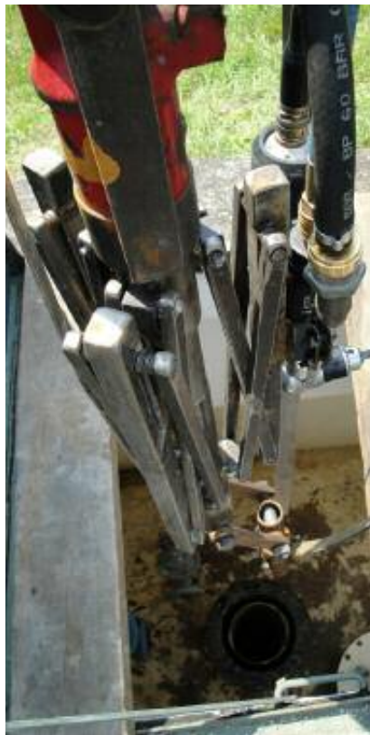
Abb. 3 Das Perforationsgerät vor dem Einbau in den Brunnen
