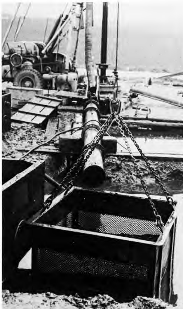
3 Siebkasten zum Auffangen der Kohle aus der Spülung
