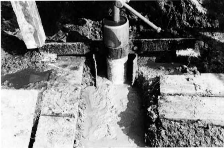
Bild 3: Verdrängte Dichtmasse im Auslaufgraben
