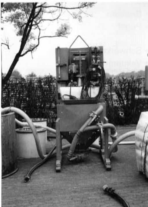
Bild 1: Kolloidalmischanlage mit Vorratsbehälter
